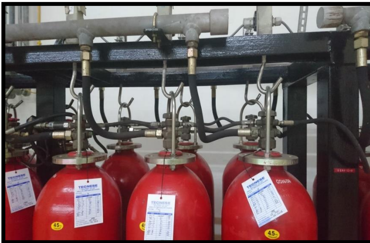
Conexión de los extintores al sistema
